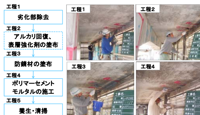
鉄筋腐食によるひび割れの補修事例
