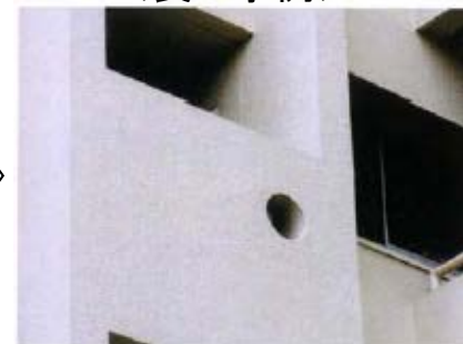
原因特定にもとづく適切な改修により、15年経過後もひび割れの発生なし
