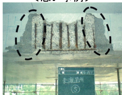
劣化原因に対する配慮が十分でなく、短期間のうちに再劣化した例
