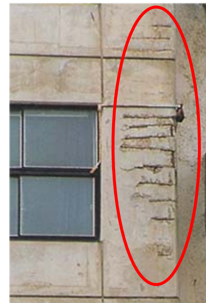
中性化によるひび割れの例 (鉄筋に沿ったひび割れ)
