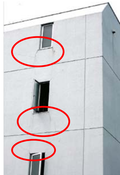
乾燥収縮によるひび割れの例 (窓の隅角部のひび割れ)
