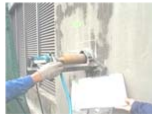
コア強度試験によるコンクリート強度の確認(破壊調査)
