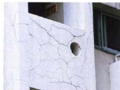
定期点検による外壁のひび割れ確認と原因の特定
