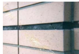
改修前のシーリング材
