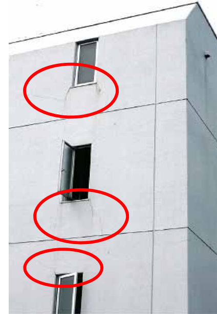
乾燥収縮によるひび割れの例 (窓の隅角部のひび割れ)
