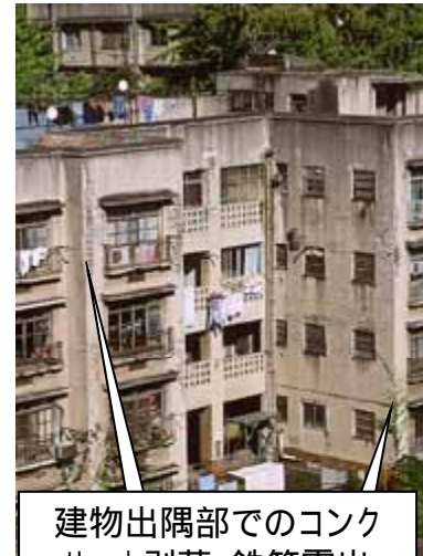
同潤会アパートにおけるコンクリートの状況
