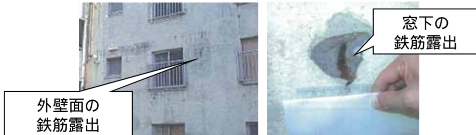
経年によりコンクリートが剥離し、外壁面の鉄筋が露出している事例
